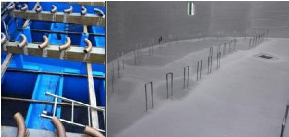
Fotos: Aspecto final de impermeabilizações com POLYUREA RAYSTON . Digestor em ETAR de Sevilha, numa fábrica papelreira, em Tortosa (Tarragona). A POLYUREA RAYSTON pode ser aplicada sobre diferentes suportes, como betão, metal, tubos PVC, etc. Para cada tipo de suporte, existe um primário específico que se deverá aplicar, compatível com esse material.
