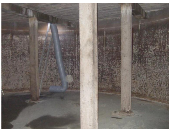
Foto: Ventilação forçada num depósito de água potável, com o objectivo de, após a preparação adequada da superfície, deixá-la secar completamente, antes de se avançar para a aplicação do primário.
