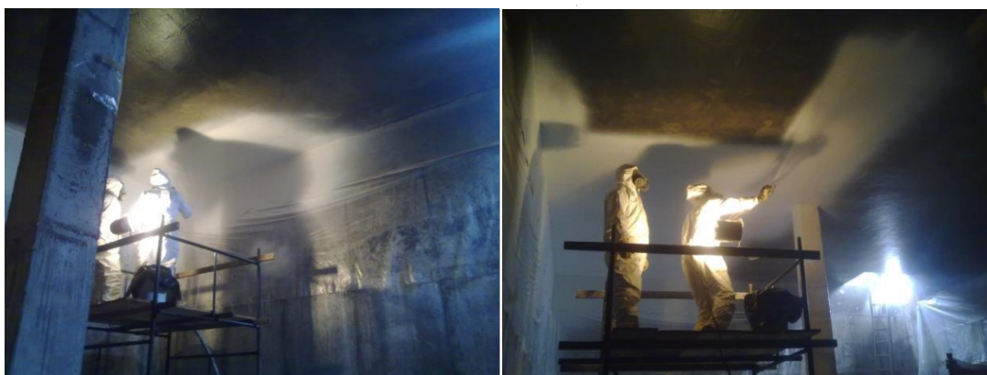
Fotos: Aplicação da POLYUREA RAYSTON no interior de um tanque na ETAR de Itaperçu, Sanepar (Brasil).
